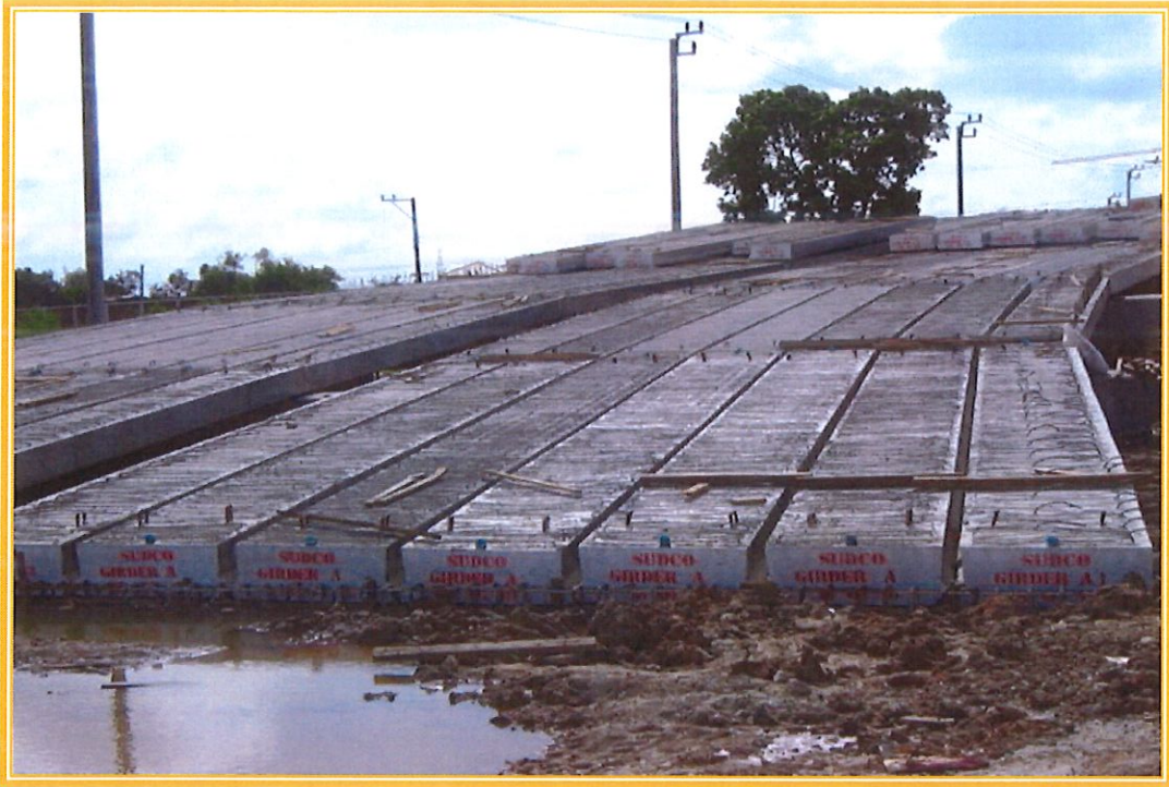
โครงการก่อสร้างสะพานข้ามคลอง หมู่บ้าน ปาริชาต ยาว 170 ม. ถนนคัมเกล้า กรุงเทพฯ
